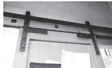
写真2-22 残存した引き戸 2010年
